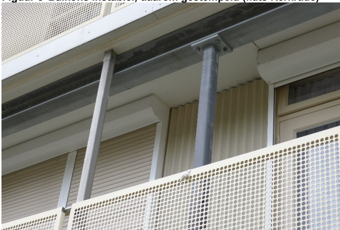
Figuur 8 Balkons instabiel, daarom gestempeld (flats Kerkrade)
